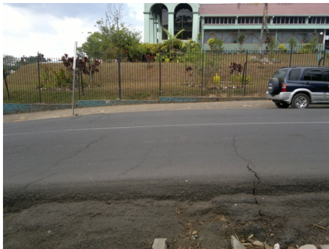
Figura 1.2 Agrietamientos frente a Iglesia Nueva
